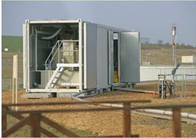
Abbildung [4] : Demonstrationsanlage zur P-Rückgewinnung am Standort der LSZ in Boxberg
