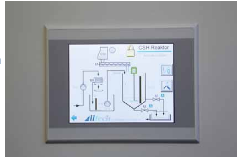
Touchscreen zur Steuerung der P-RoC-Anlage
