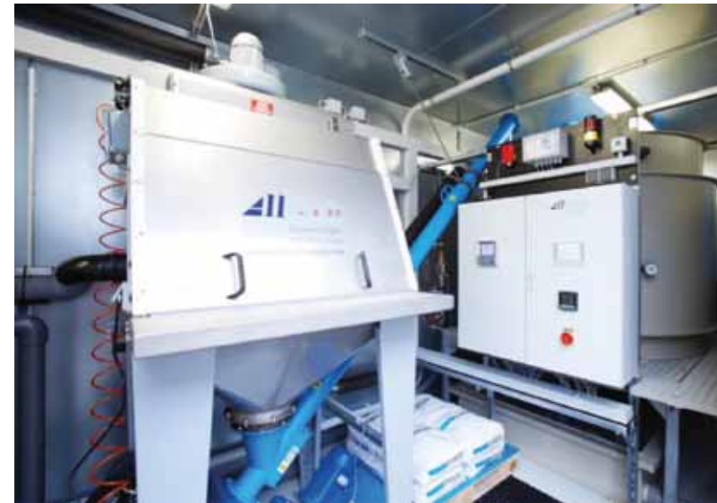
CSH-Aufgabestation und CSH-Reaktor mit Steuerung
